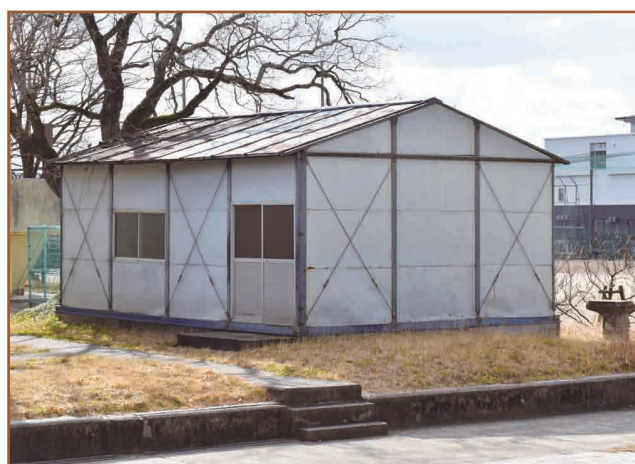
老朽化した屋外倉庫
